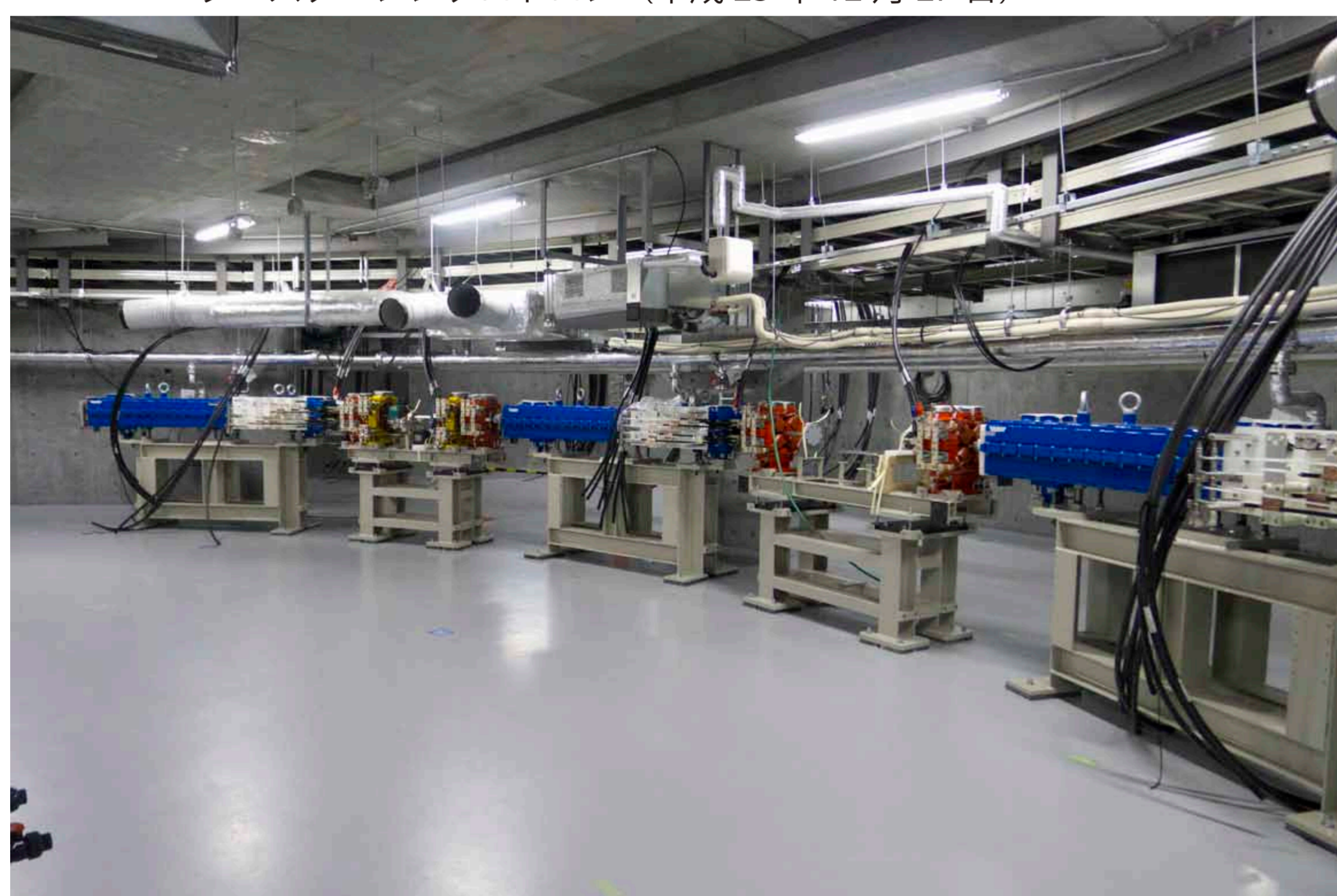
ブースターシンクロトロン (平成 23 年 12 月 27 日)
